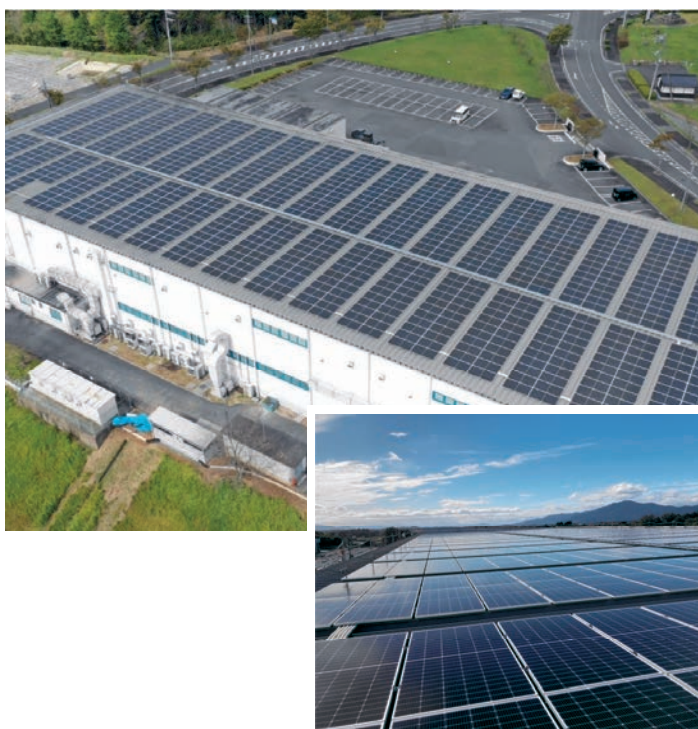
▼屋上に設置した太陽光パネル
