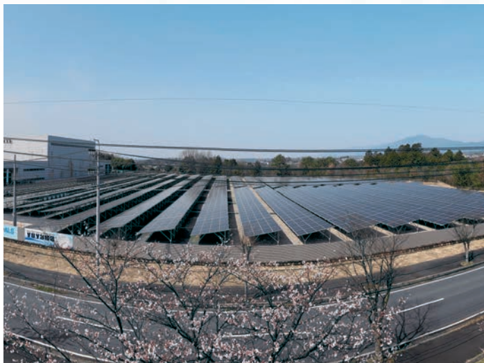
▼敷地内に設置した太陽光パネル
