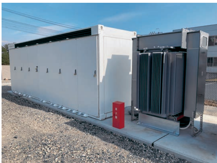
▼蓄電池システム
